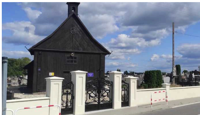
Zabytkowy kościół w Parzęczewie — ogrodzenie kościoła modrzewiowego i cmentarza, pod nadzorem konserwatora zabytków.
